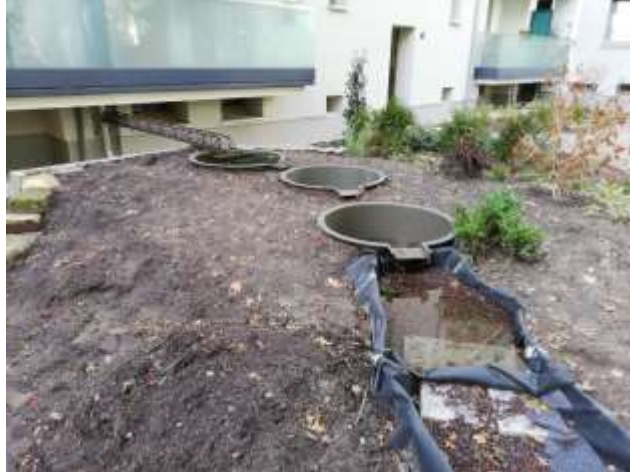
Bild 2-5: Oberirdische Zuleitung vom Fallrohr zu einem Teich mit Uferversickerung (Quelle: aqua-planer)
