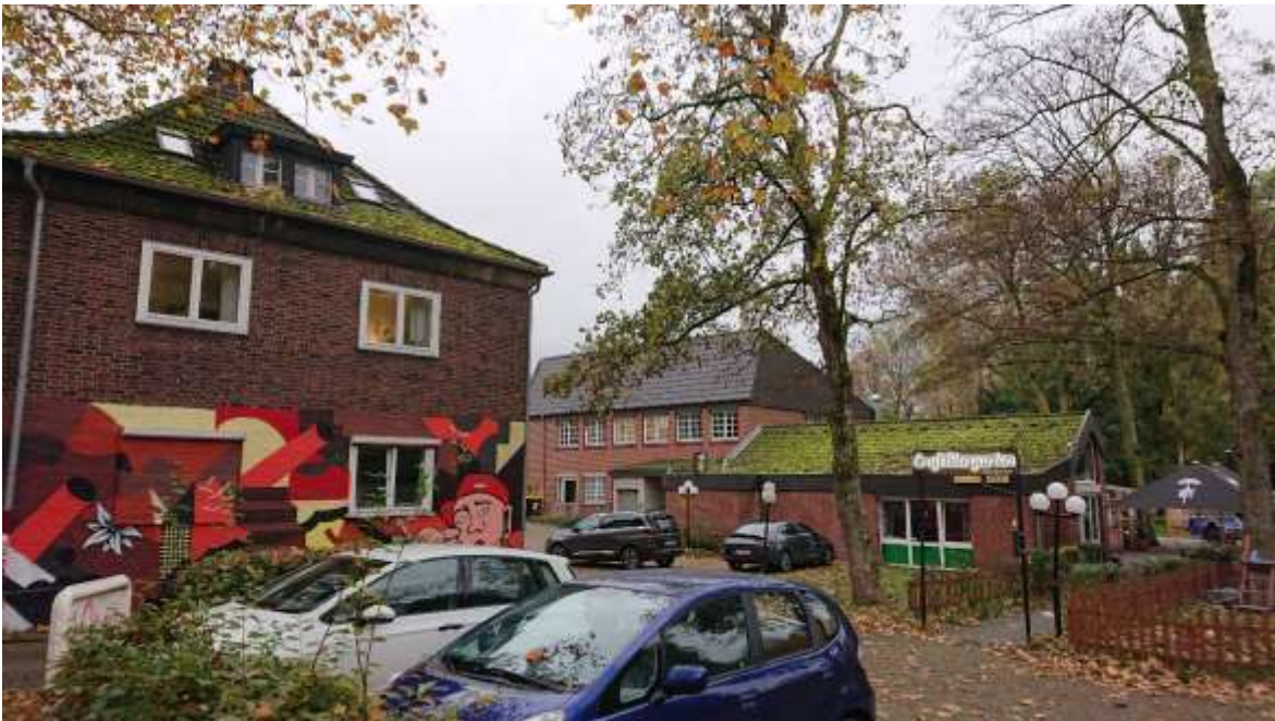
Bild 5-2: 20° bzw. 40° steiles Dach mit Ziegeleindeckung und flächig mit Moos bewachsen [Quelle: eigene Darstellung]
