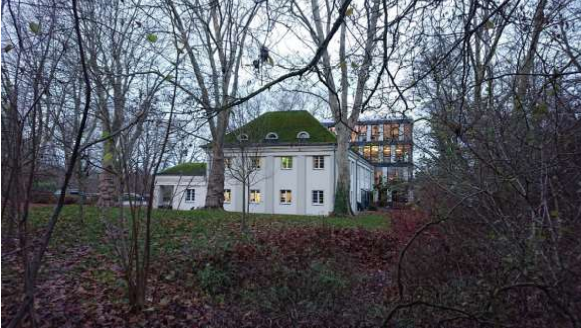
Bild 5-1: 45° steiles Dach mit Bitumenbahndichtung, flächendeckend mit Moosen bewachsen [Quelle: eigene Darstellung]
