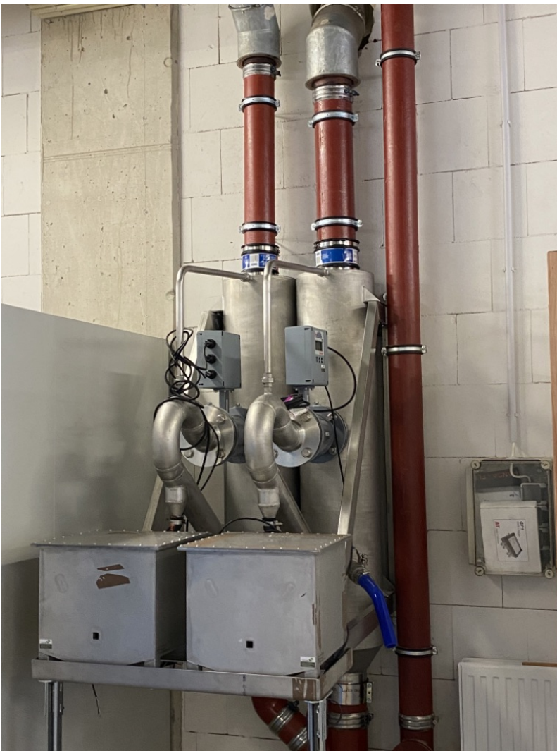
Bild 10: Eingebaute Abflussmessvorrichtung [Quelle: LHH, eigenes Foto]
